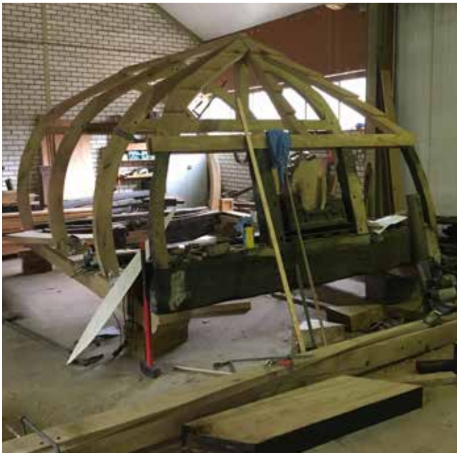
De kapconstructie is grotendeels vernieuwd. Dat is logisch, omdat de hitte van de brand zich daar voornamelijk heeft geconcentreerd.
