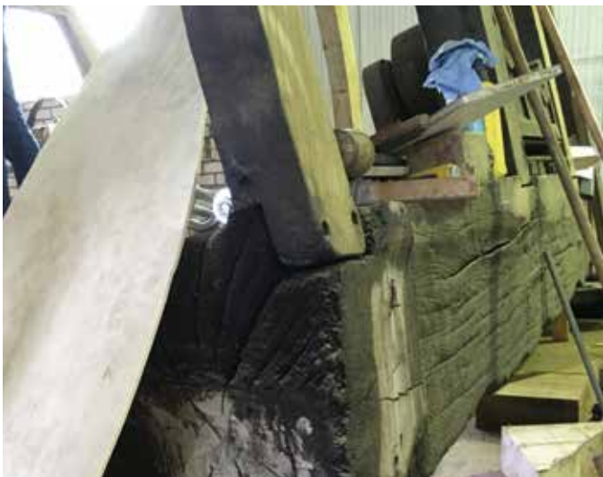
De windpeluw heeft het overleefd, de daklijsten niet.
