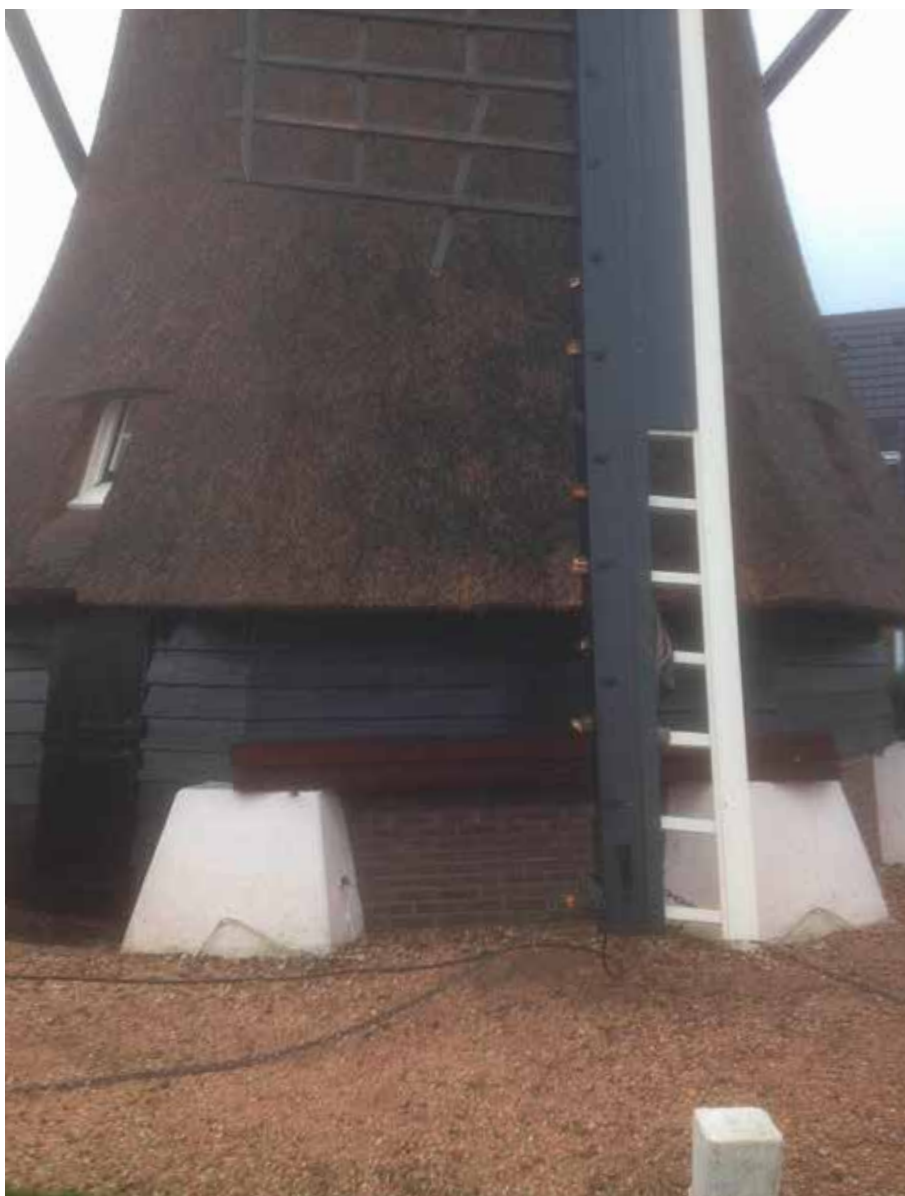
De schade aan het gevlucht
