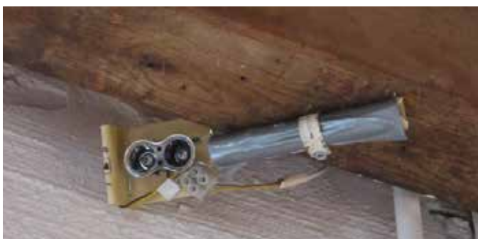
Signaallicht gemonteerd tegen zolderbalk; UIT
