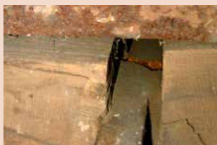
De asbreuk, net zichtbaar tussen de vulstukken
