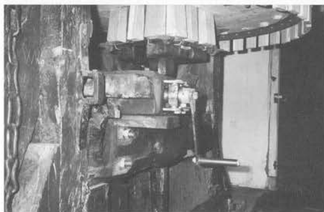
Het opvoerwerk is uit zijn werk te zetten door met behulp van de slinger de wervel te verzetten waardoor de onderbonkelaar het waterwiel niet meer aandrijft.
