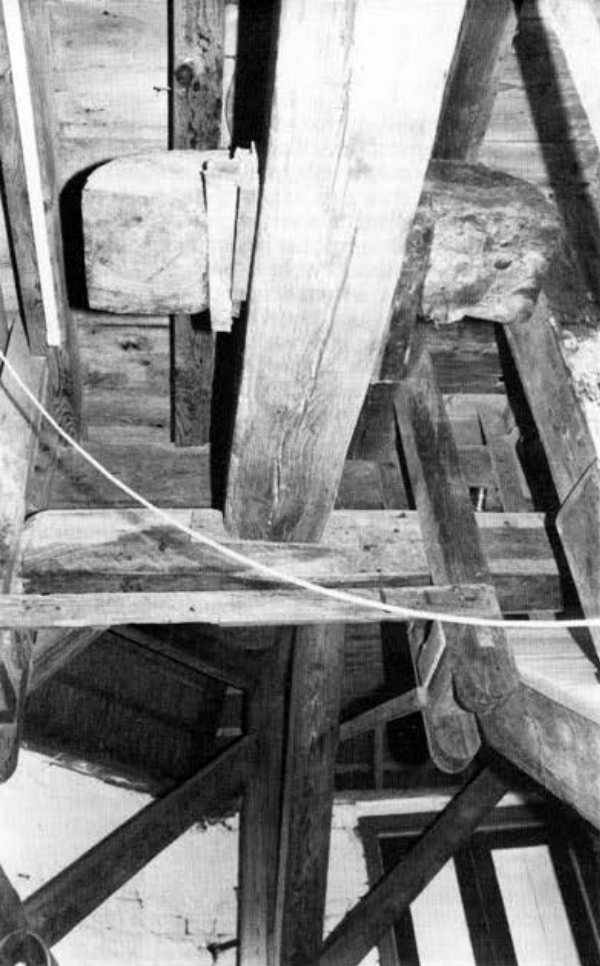
Afb. 2: Het lichtwerk in de molen te Noordwolde (Fr). Foto door H. Hachmer te Noordwolde.
